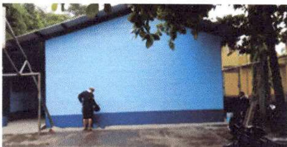
Foto 5: Pintura en muros exteriores en módulo 1
